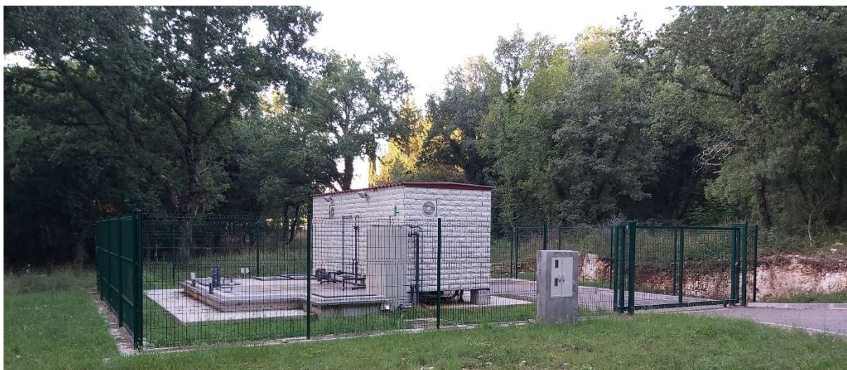
Slika 6. Uređaj za pročišćavanje otpadnih voda Kloštar
