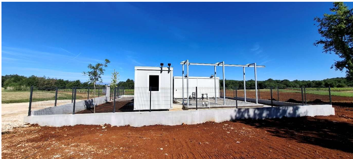
Slika 7. Uređaj za pročišćavanje otpadnih voda Flengi
